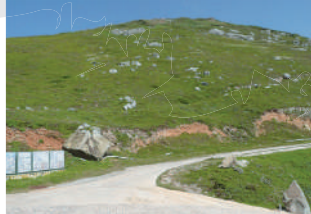
▲東引清水澳土壤崩塌
